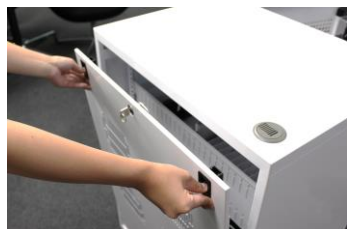
背面は鍵付パネル仕様 ケーブルの処理などが行えます
